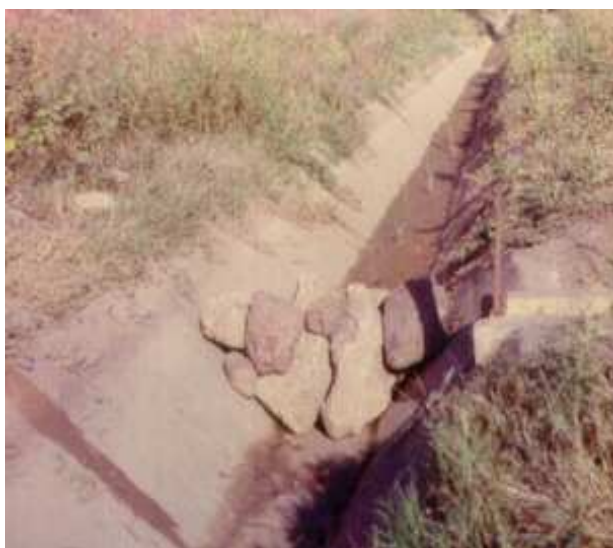
Figure 9 : Amoncellement de blocs de pierre au travers du canal pour rehausser le niveau de l'eau au droit de la prise
